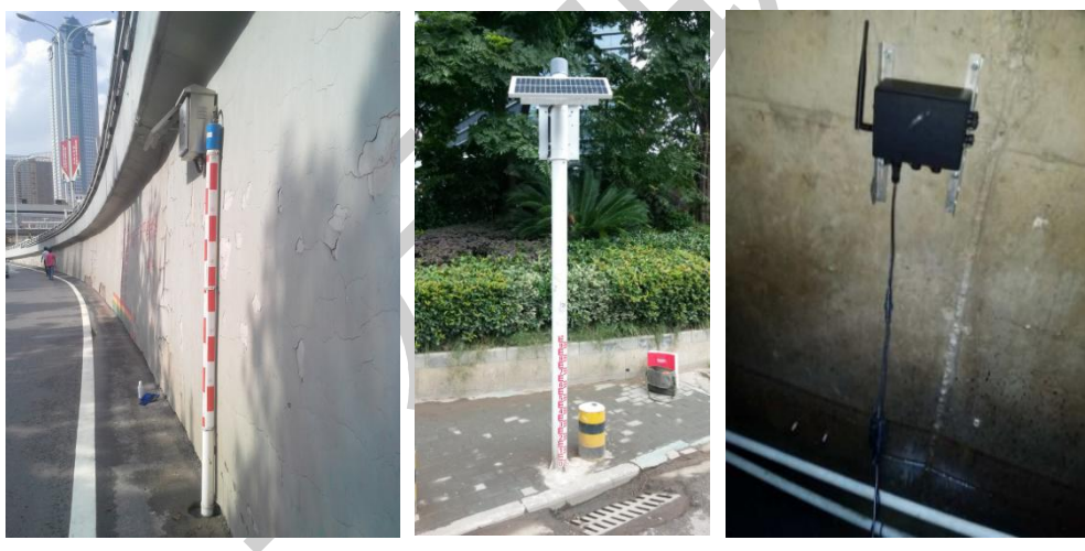
图3 “城市水联网”监测设备安装实例
